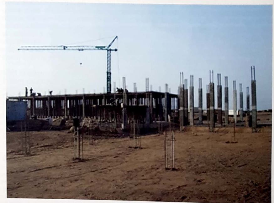
La gru, la soletta della scuola di Massaua. Una recente foto dove si notano i notevoli progressi della costruzione.
